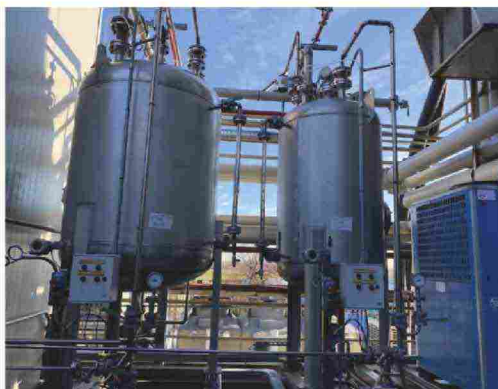
L'IMPIANTO PILOTA REALIZZATO COL PROGETTO LIFE-TRIALKYL
